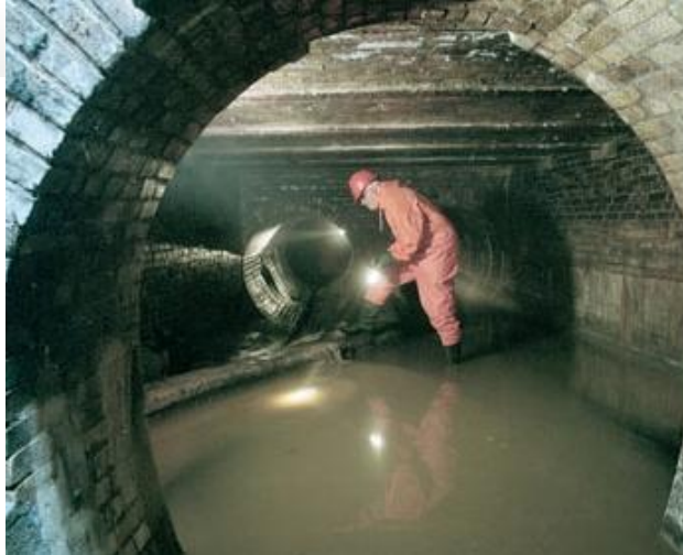
Besøg i fælleskloak på en tørvejrsgang
